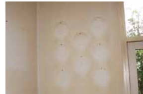
Farveforskel på vægge efter nikotin eller stearinlys.
