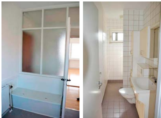
Eksisterende badeværelse samt bæk ved køkkenvæg
