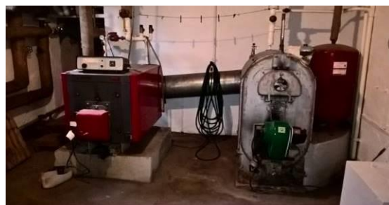
Oliekedler i kælder. Nyere kedel er fra 1998.
