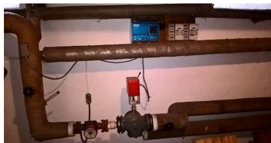
Blandesløjfe, pumpe og vejrkompensering i kælder.
