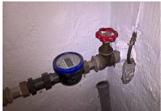
Fælles vandstik i kælder for bygningen, udført i galvaniseret stål.
