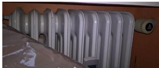
Radiator i værelse i lejlighed.
