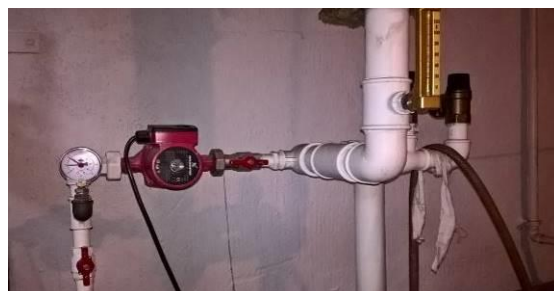
Uisolerede varmerør i kælder.
