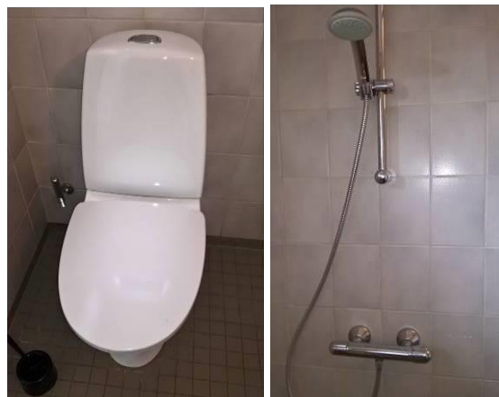
Toilet og blandingsbatteri for bruser i badeværelse.
