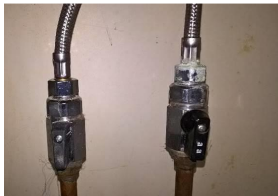
Tegn på utæthed ved omløber under køkkenvask.
