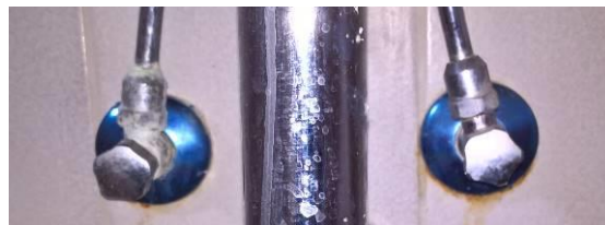
Tegn på tæring/utæthed i væg ved afspærringsventiler under håndvask i badeværelse.
