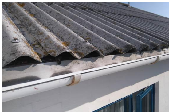
Pladekanterne er under nedbrydning
