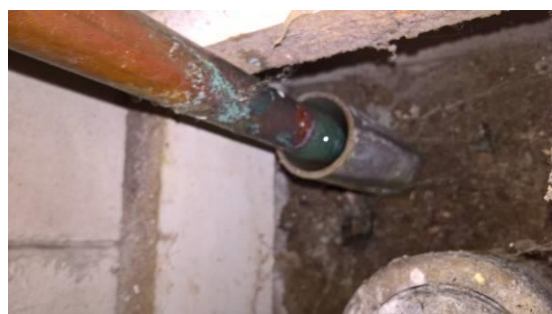
Afløb fra sikkerhedsventil i teknikskab er tilstoppet.
