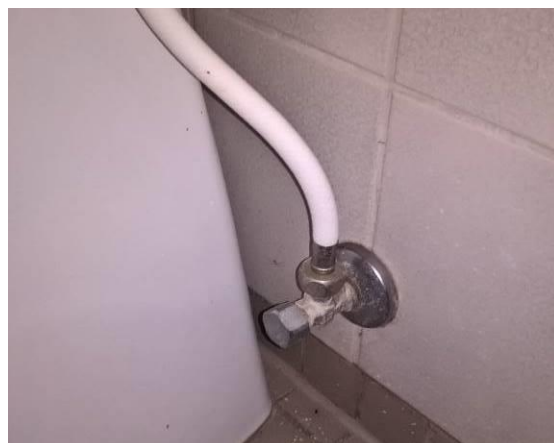
Tegn på utæthed ved omløber på tilslutningslange for toilet på badeværelse.
