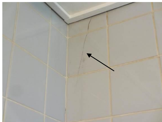
Revne i fliser i hjørnet
