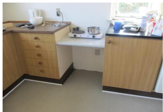
Vinylgulvbelægning i køkken
