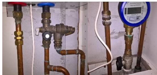
Tegn på tæring/utæthed ved tilslutning af overløb til sikkerhedsventil, samt ved samling på koldt vandsrør.
