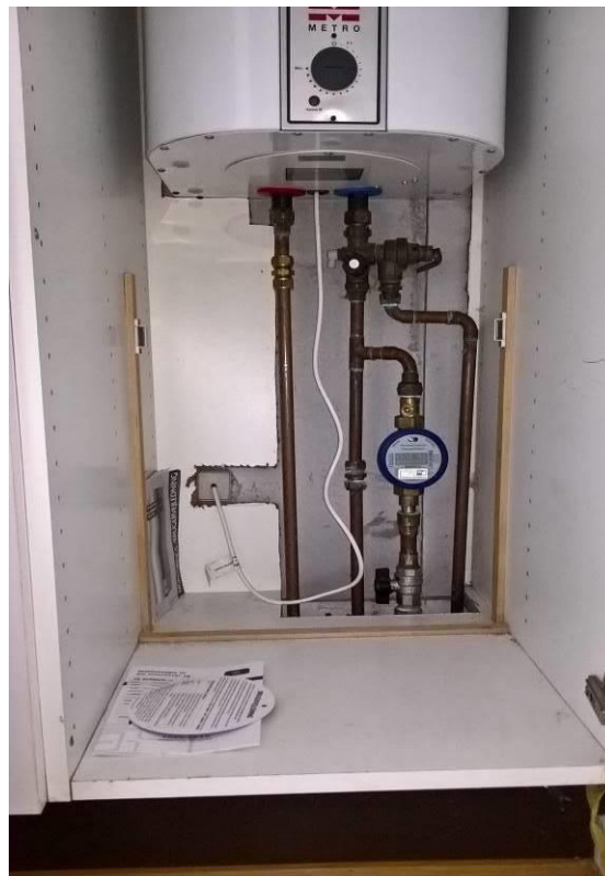
Vandstik ført ind i teknikskab under varmtvandsb Tilslutning til varmtvandsbeholder i teknikskab
