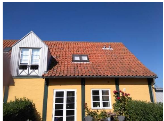
Bygning N – tagflade mod gården, algevækst
