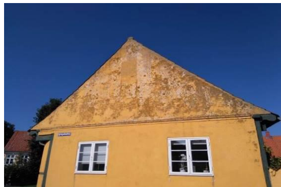
Bygning V – skader ved gavl mod syd
