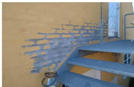
Bygning N – skader ved gavl mod øst
