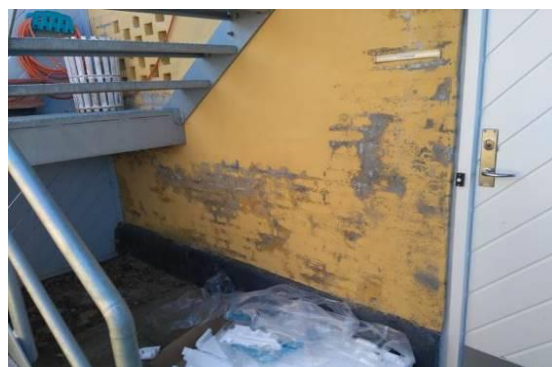
Bygning N – skader ved gavl mod øst
