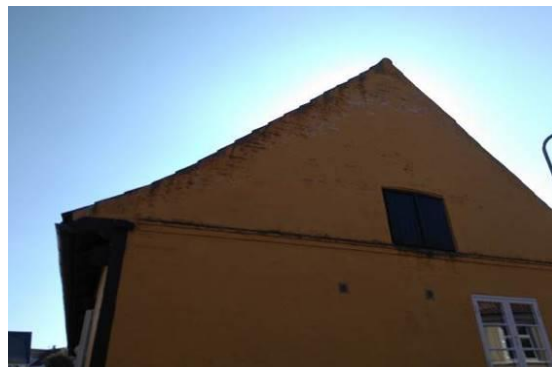
Bygning V – fugt i gavl op ved tagsten
