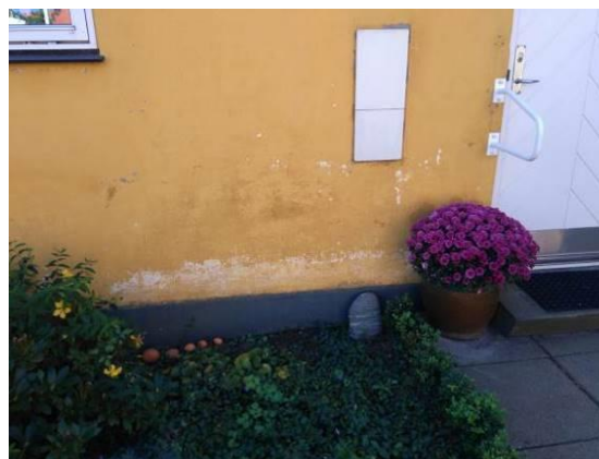
Bygning S – opfugtet facade mod gården
