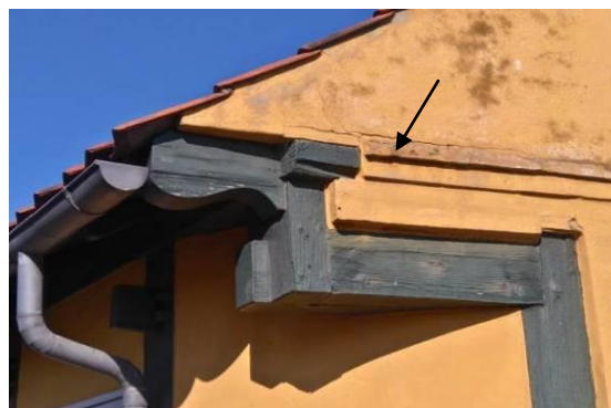
Bygning V – vandret revne i murværk over bindingsværk
