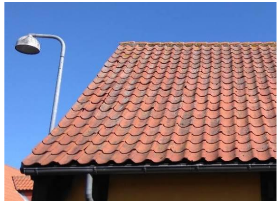
Bygning V – ujævn tagflade mod nordvest
