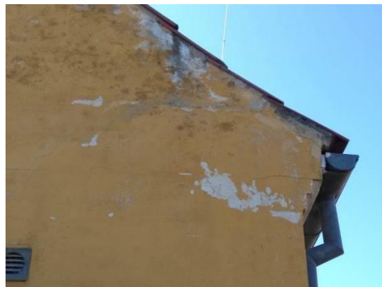
Bygning S – skader ved gavl mod øst
