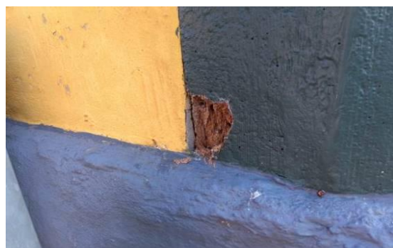
Bygning V – skader ved bindingsværk
