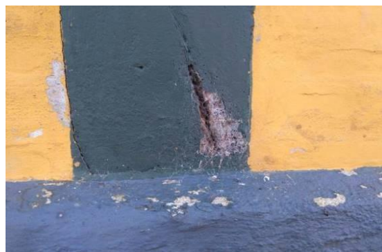
Bygning N – skade i bindingsværk og murværk mod nord
