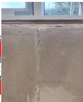
Der er fundet en del revner i væggene på Norre Bakke.
