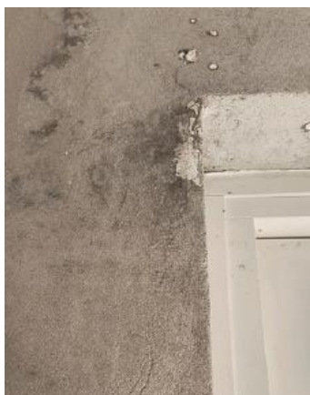
Skimmel på vægge, fjernes i forbindelse med renoveringen.
